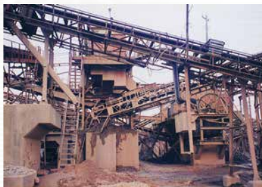
1965年代 (昭和40年代) 採石プラント納入(本庄市、熊谷市)
